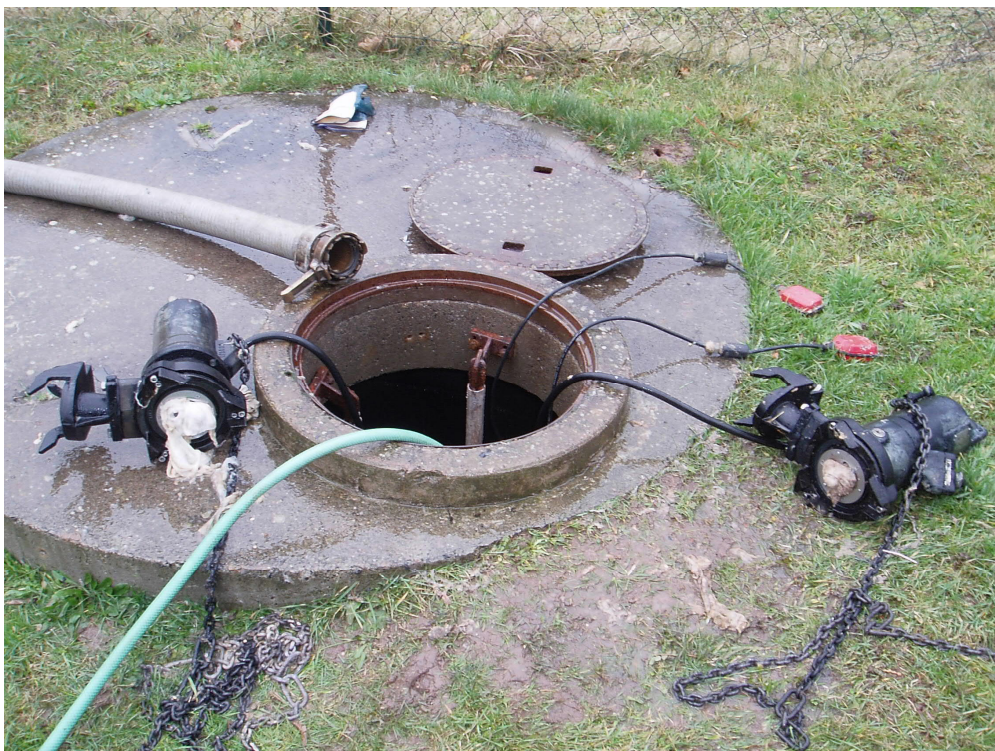
Bild: Zwei verstopfte Schmutzwasserpumpen
